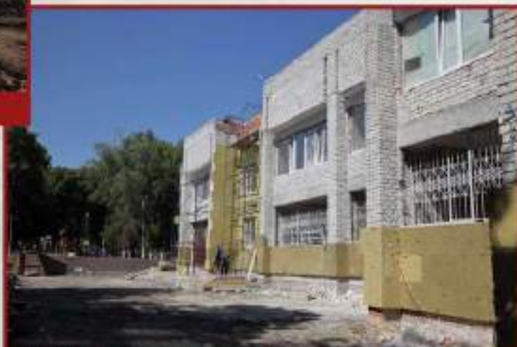
Восстановление Дворца культуры железнодорожников, повреждённого в ходе боя за город. ДНР, Волновата, август 2022 г.
